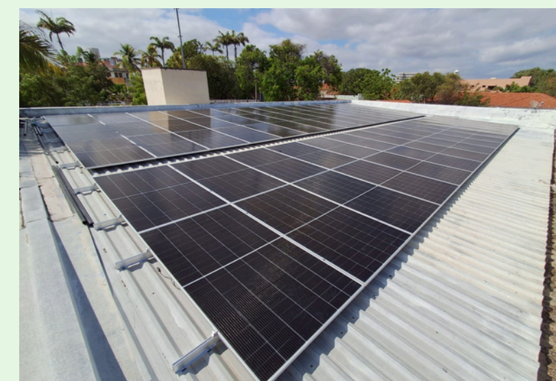
Placa Solar instalada no Fórum Eleitoral de Sobral
