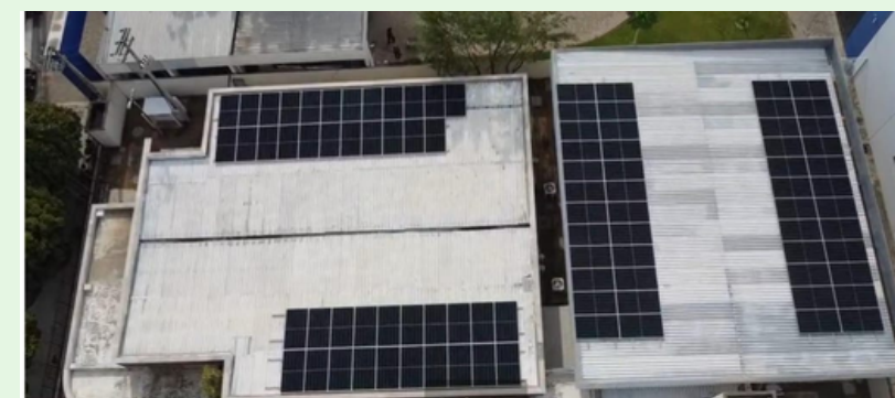
Placa Solar instalada no Fórum Eleitoral de Juazeiro do Norte
